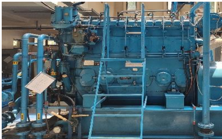
Gambar 4. Mesin Diesel Induk
